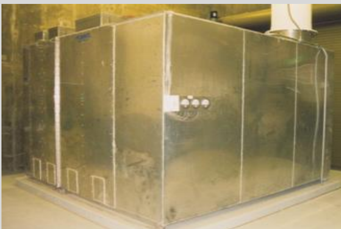
Skruber awaryjny poziomy – do neutralizacji 1000kg SO 2 , wykonanie z aluminium, lokalizacja wewnątrz.
